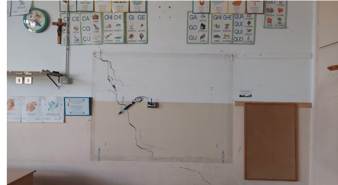
Fessurazioni su sottofondo riconducibile al cedimento
