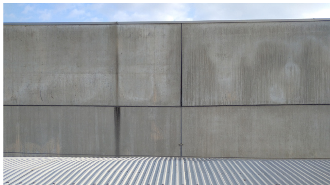
Dissesti in copertura riconducibili al cedimento
