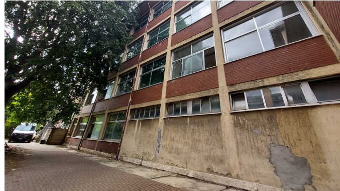
Vista dall'esterno del pilastro oggetto di cedimento
