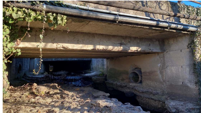
Vista del ponte con evidente scalzamento alla base della pila
