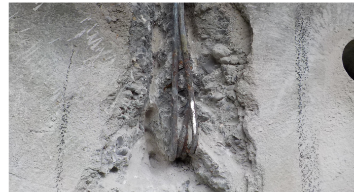
Espulsione di copriferro ed armature ossidate
