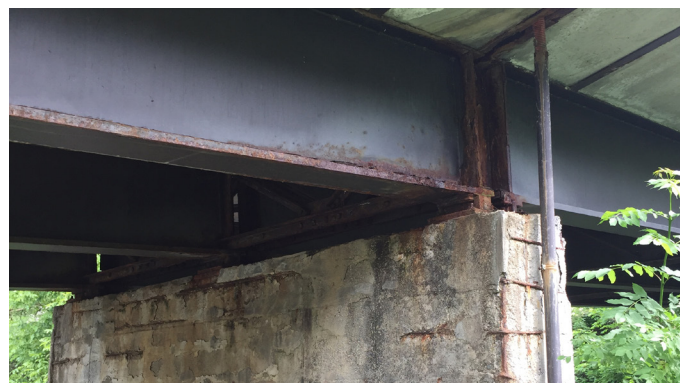
Fenomeno di degrado all'appoggio dell'impalcato
