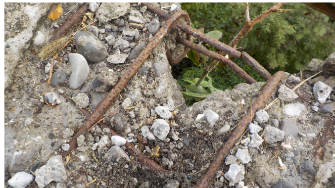
Espulsione di copriferro ed armature ossidate
