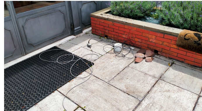
Dettaglio sensori di misura
