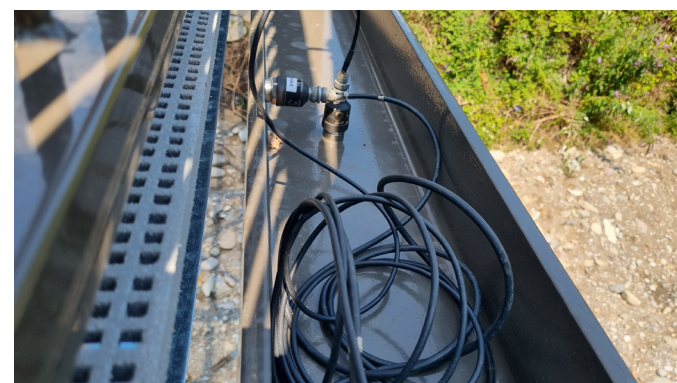
Dettaglio sensori di misura
