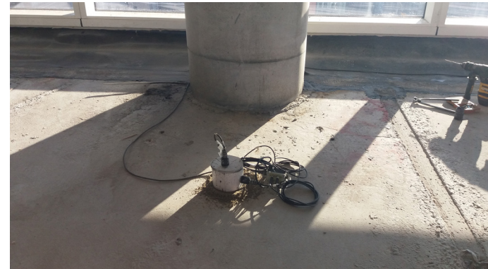
Dettaglio di terna accelerometrica
