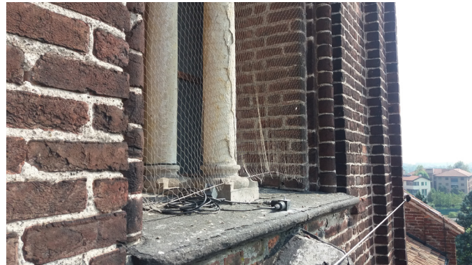
Posizione di accelerometro
