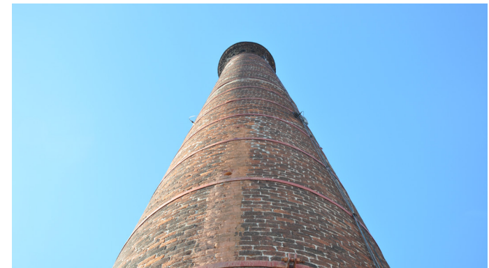
Posizione di accelerometri sulla ciminiera
