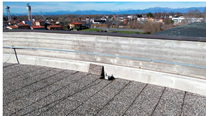
Posizione di accelerometro in copertura
