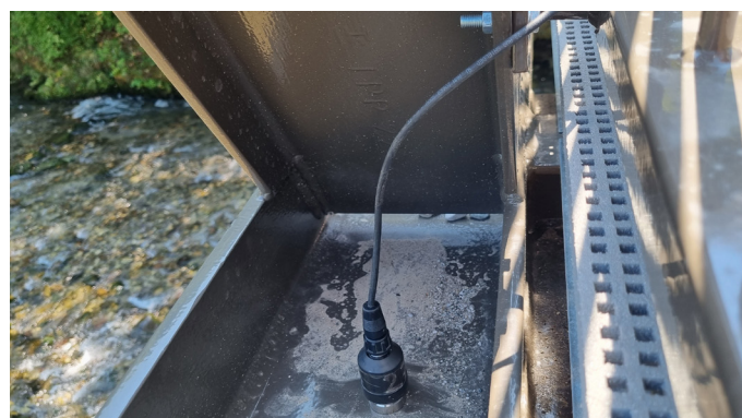
Dettaglio sensori di misura
