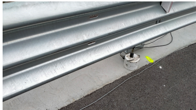
Dettaglio sensori di misura
