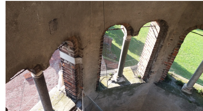
Posizione di accelerometro
