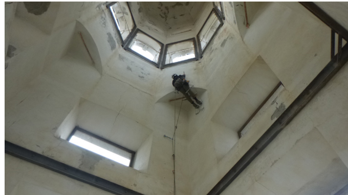
Dettaglio posa sensori di misura
