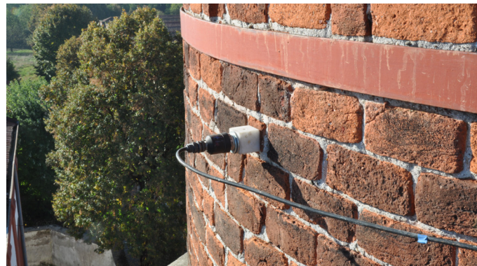
Dettaglio dell'ancoraggio dell'accelerometro
