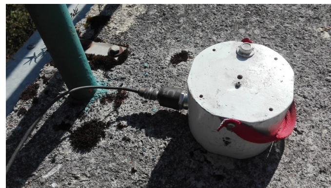
Dettaglio di terna accelerometrica
