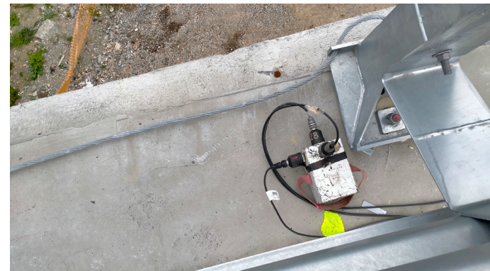
Dettaglio sensori di misura
