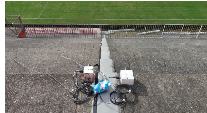
Posizione di due terne accelerometriche su giunto strutturale
