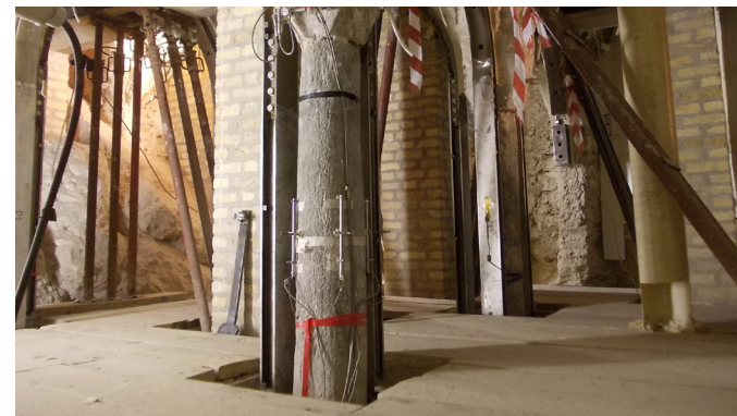
Integrazione strumentazione di monitoraggio
