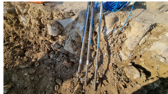
Dettaglio sonde inclinometriche fisse da tubo
