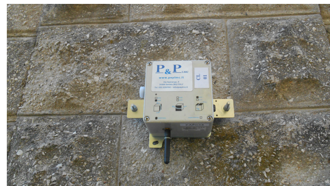
Installazione tipo inclinometro
