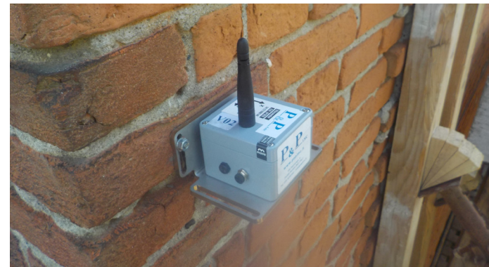
Sensore wireless installato su edifici oggetto di monitoraggio
