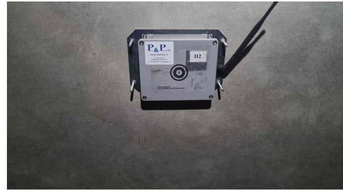
Installazione tipo misuratore dinamico di spostamento
