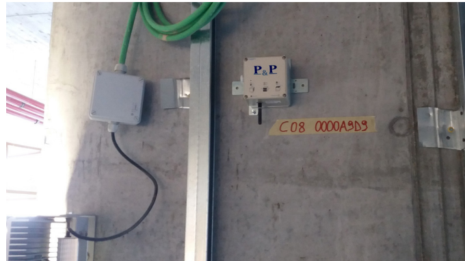
Inclinometro su setto perimetrale
