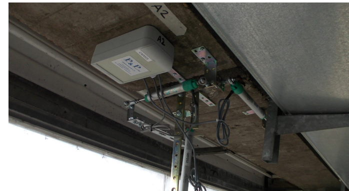
Dettaglio strumentazione quota copertura
