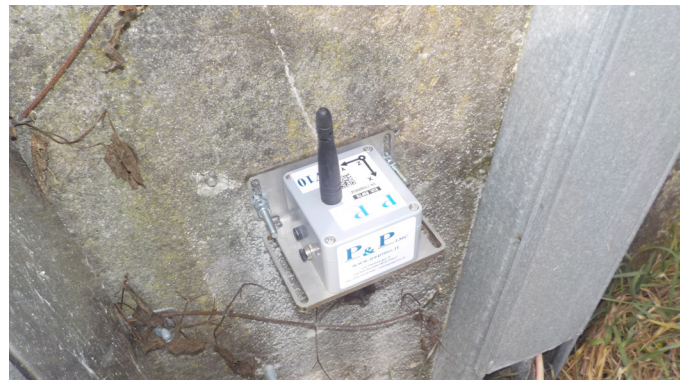
Sensore wireless installato all'imbocco della galleria
