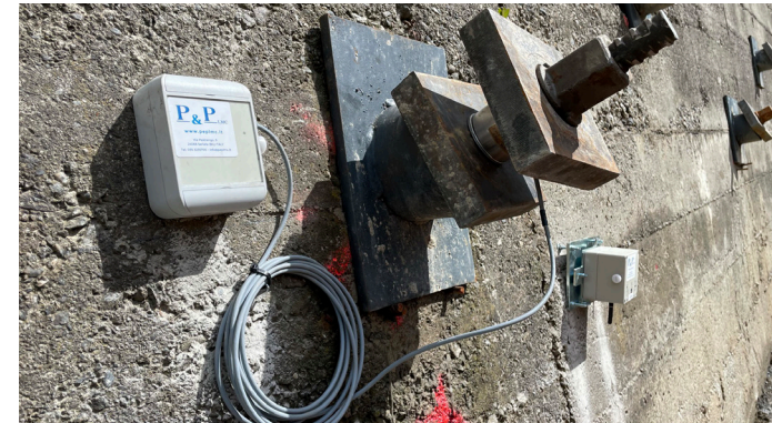
Dettaglio installazione cella di carico su tirante
