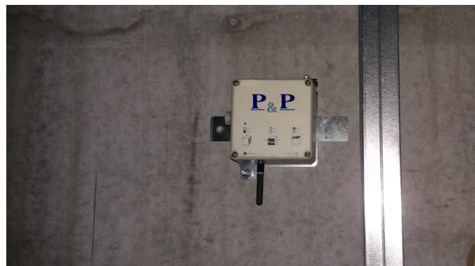
Inclinometro su vano ascensore centrale
