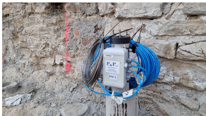
Dettaglio unità di acquisizione
