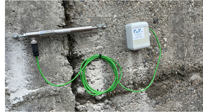
Dettaglio installazione fessurimetro
