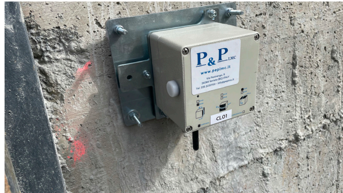
Dettaglio installazione inclinometro
