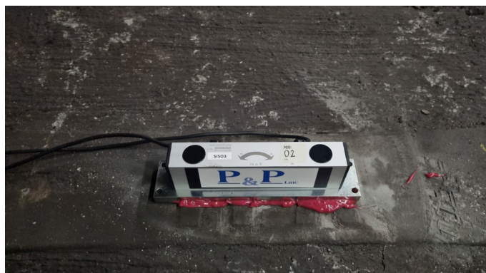
Vista di dettaglio dell'inclinometro
