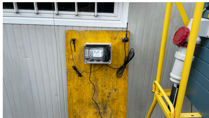
Dettaglio gateway acquisizione
