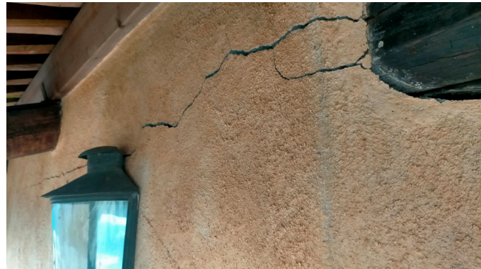
Lesione significativa su edificio oggetto di monitoraggio
