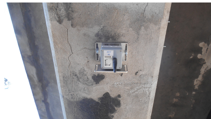
Installazione tipo accelerometro
