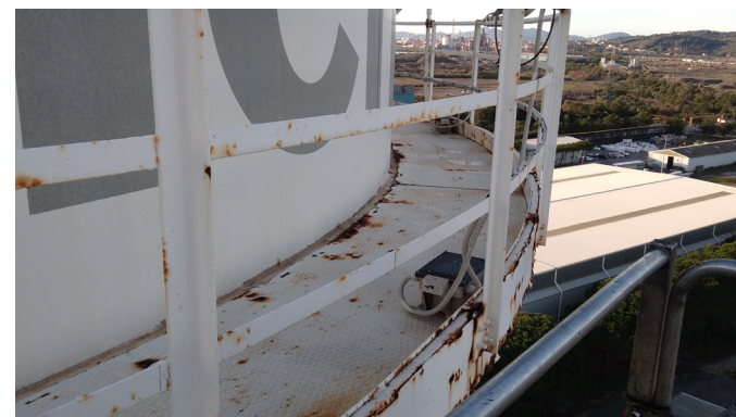
Rilievo del degrado dell'intradosso del serbatoio
