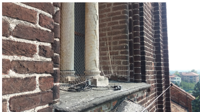
Posizione di accelerometro
