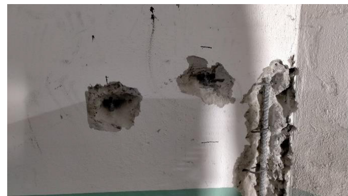
Scasso per prelievo di barra d'armatura
