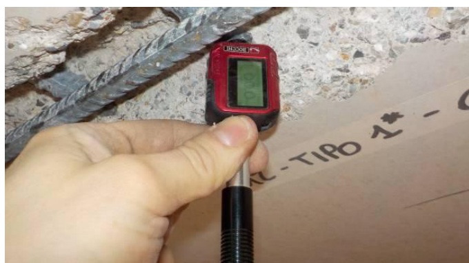
Indagine durometrica su bassa d'armatura
