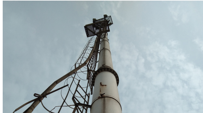
Vista dal basso di torre faro
