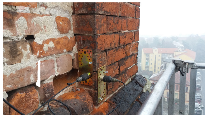
Posizione di accelerometro sulla torre
