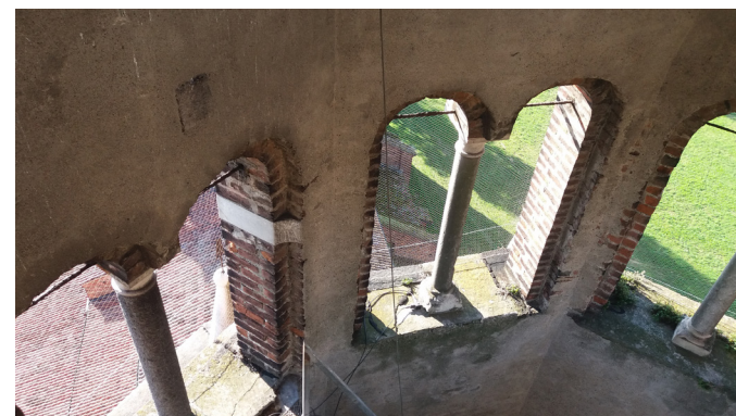
Posizione di accelerometro
