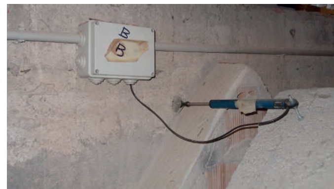
Sensore fessurimetrico all'interfaccia di elementi fondazionali
