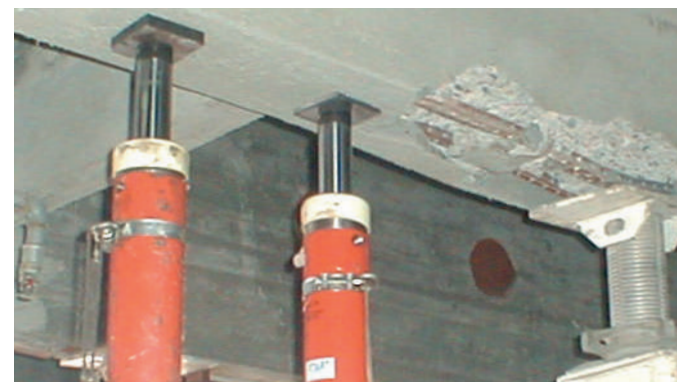
Attuatori idraulici applicati alla travi di solaio
