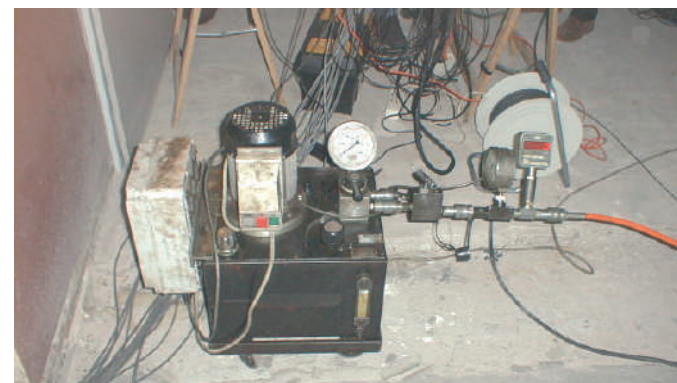
Centralina idraulica di pompaggio
