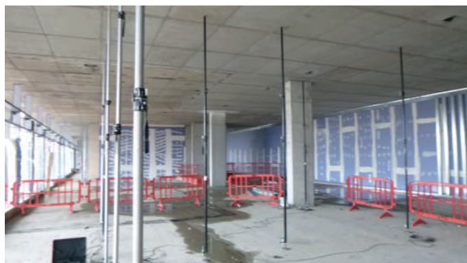
Sistema di misurazione dei cedimenti
