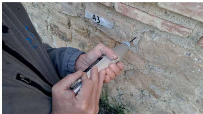
Prove penetrometrica su malta
