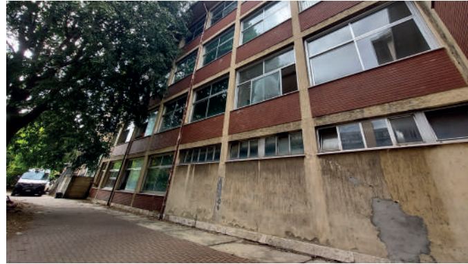
Vista dall'esterno del pilastro oggetto di cedimento
