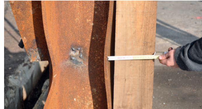
Rilievo dei dissesti
