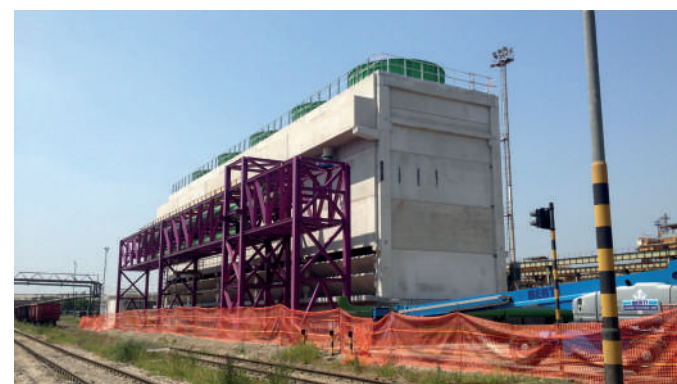
Vista dell'impianto ad intervento ultimato
