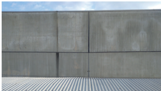
Dissesti in copertura riconducibili al cedimento
