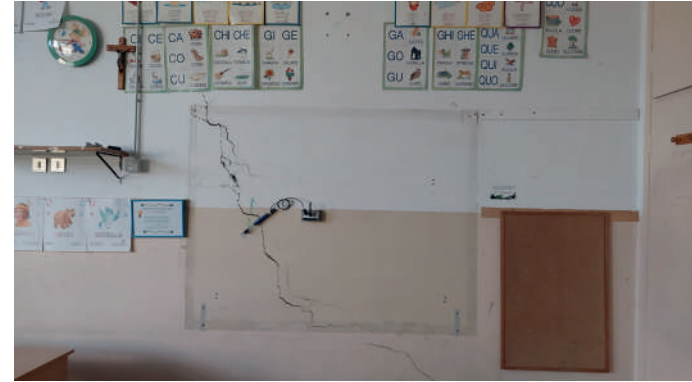
Fessurazioni su setto riconducibile al cedimento
