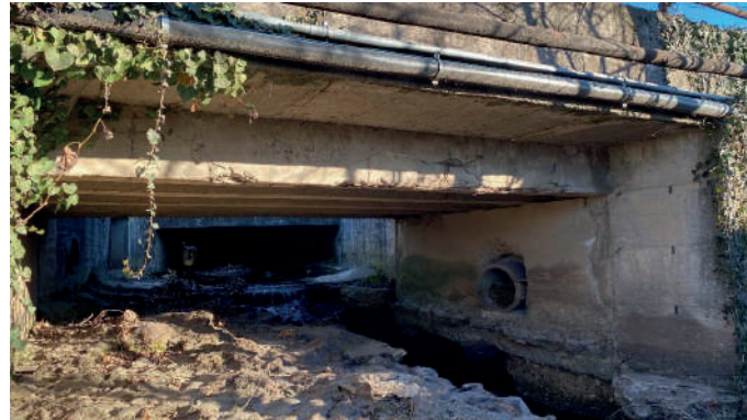
Vista del ponte con evidente scalzamento alla base della pila
