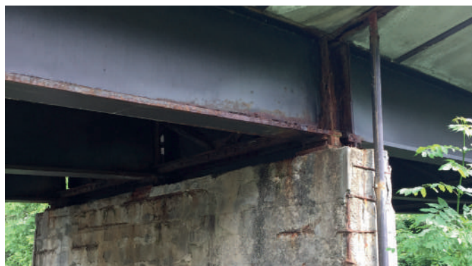
Fenomeno di degrado all'appoggio dell'impalcato
