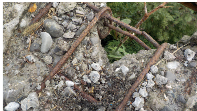
Espulsione di copriferro ed armature ossidate
