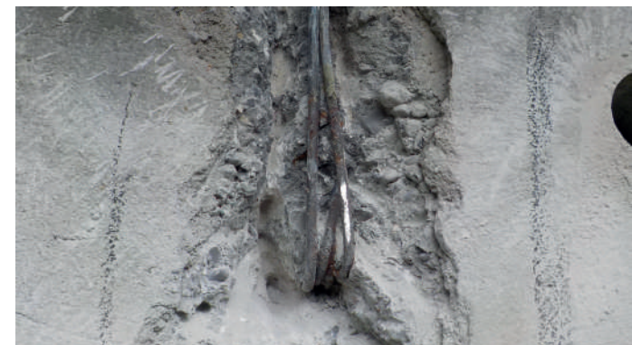
Espulsione di copriferro ed armature ossidate
