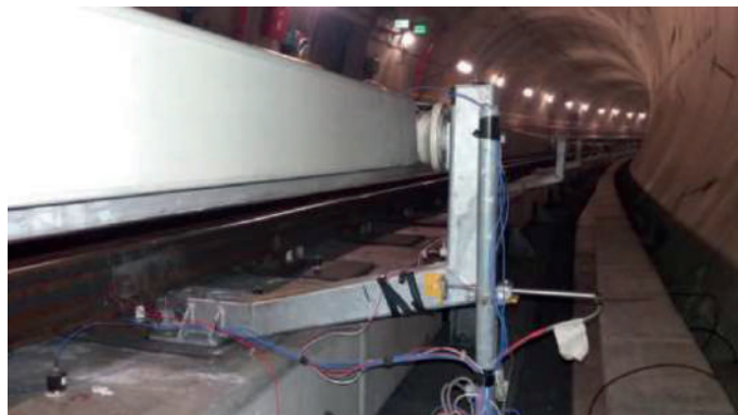
Braccio di sostegno alla terza rotaia della M5
