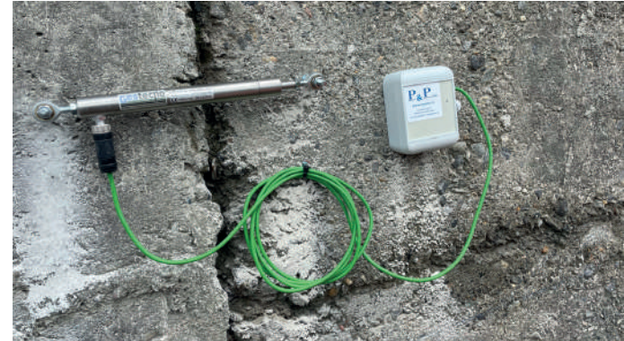
Dettaglio installazione fessurimetro
