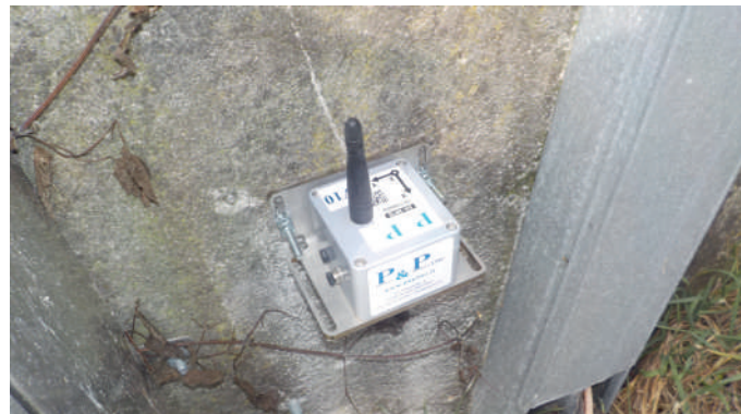
Sensore wireless installato all'imbocco della galleria
