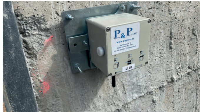
Dettaglio installazione inclinometro
