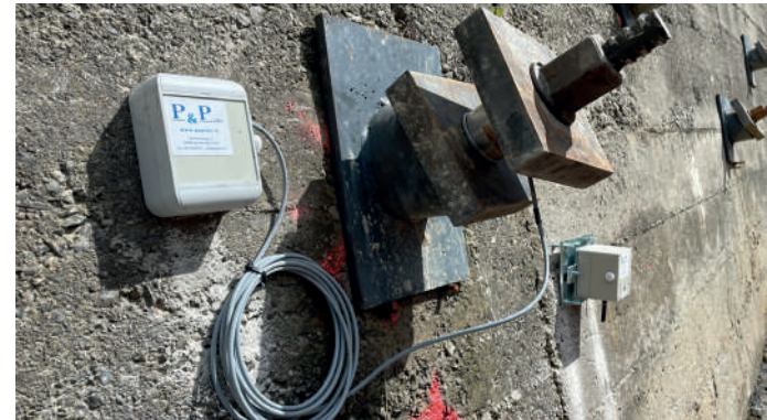
Dettaglio installazione cella di carico su tirante
