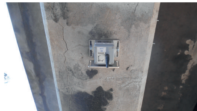
Installazione tipo accelerometro
