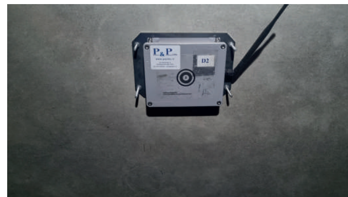
Installazione tipo misuratore dinamico di spostamento
