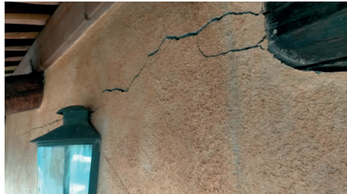
Lesione significativa su edificio oggetto di monitoraggio
