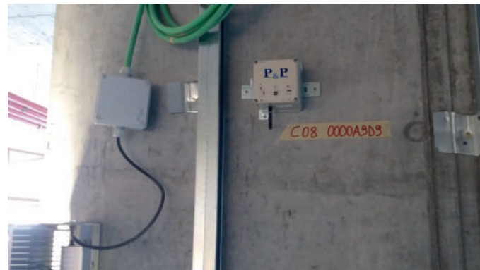
Inclinometro su setto perimetrale
