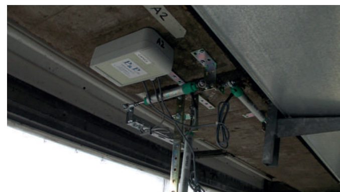
Dettaglio strumentazione quota copertura
