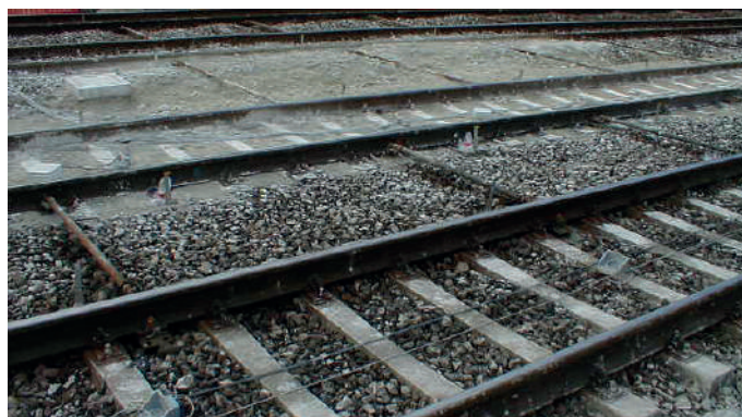
Vista d'insieme sistema di monitoraggio delle linee
