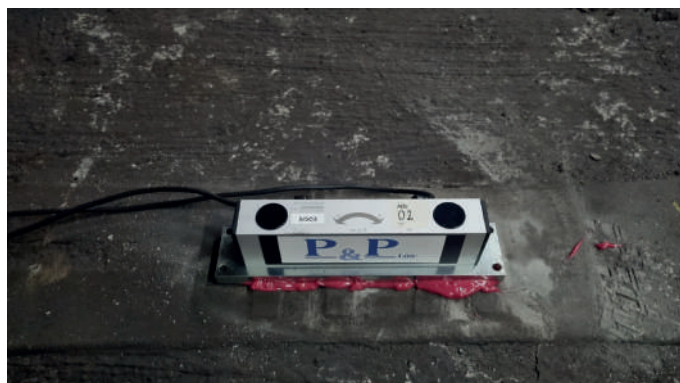
Vista di dettaglio dell'inclinometro
