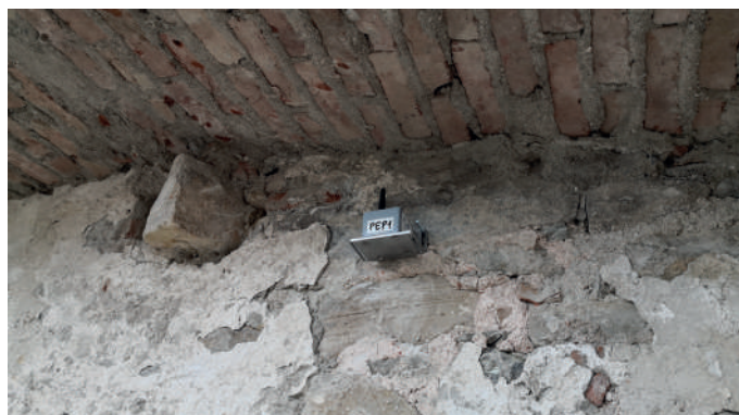
Vista installazione tipo vibrometro
