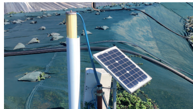
Testa di tubo inclinometrico oggetto del monitoraggio
