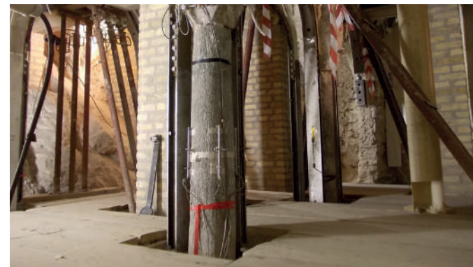
Integrazione strumentazione di monitoraggio
