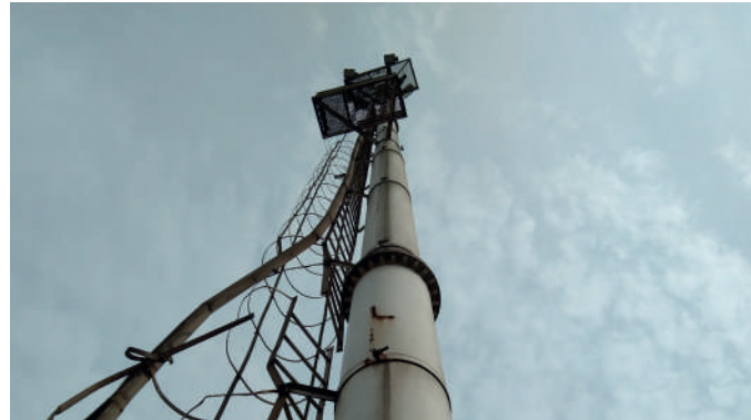
Vista dal basso di torre faro
