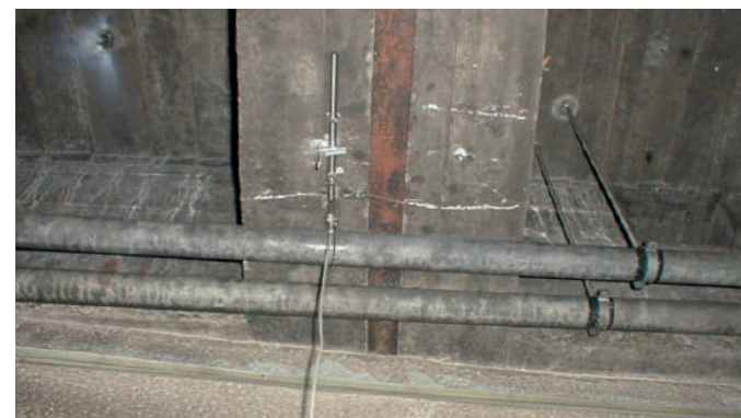
Misura di sollecitazione tramite sensore di deformazione
