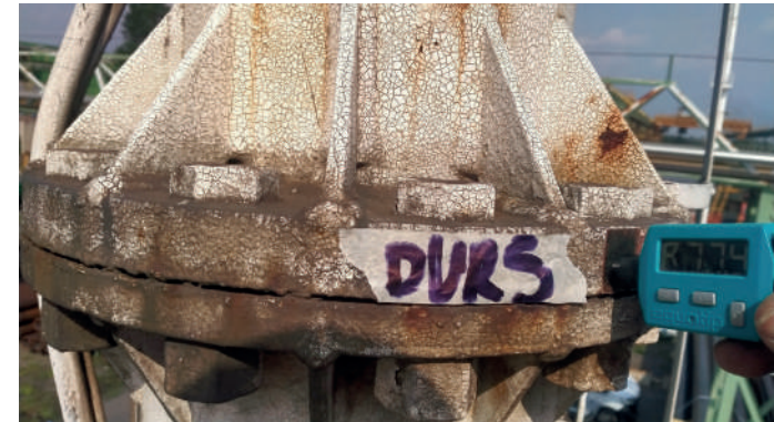
Indagine durometrica su piastra di unione di due elementi
