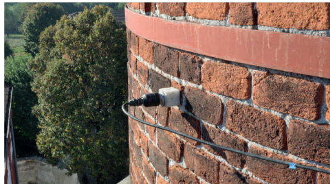
Dettaglio dell'ancoraggio dell'accelerometro
