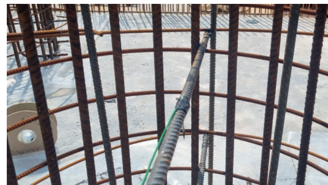
Sensore di temperatura posizionato all'interno di pilastro
