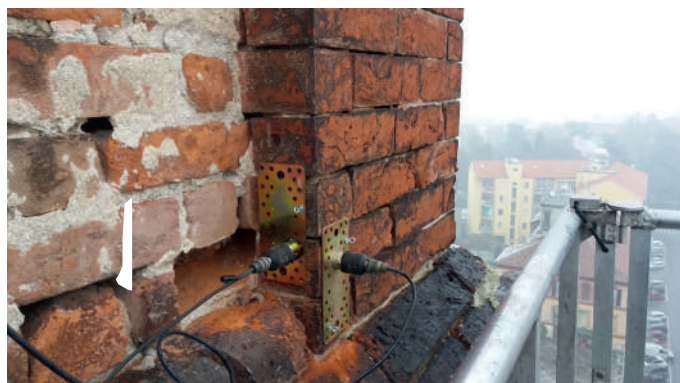
Posizione di accelerometro sulla torre
