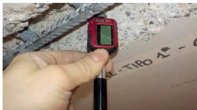
Indagine durometrica su bassa d'armatura
