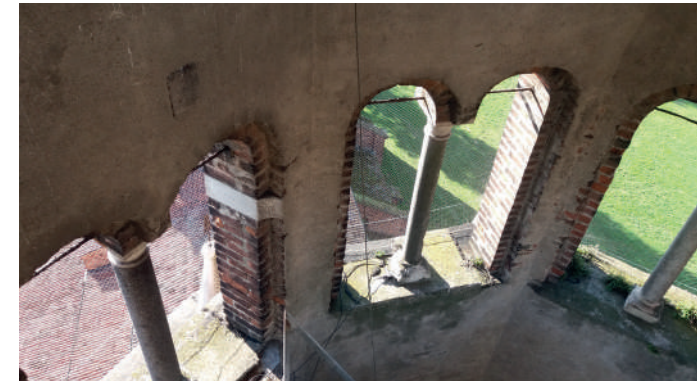
Posizione di accelerometro
