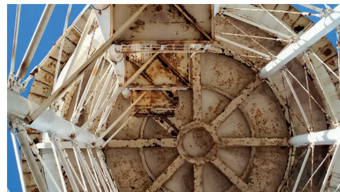
Rilievo del degrado dell'intradosso del serbatoio
