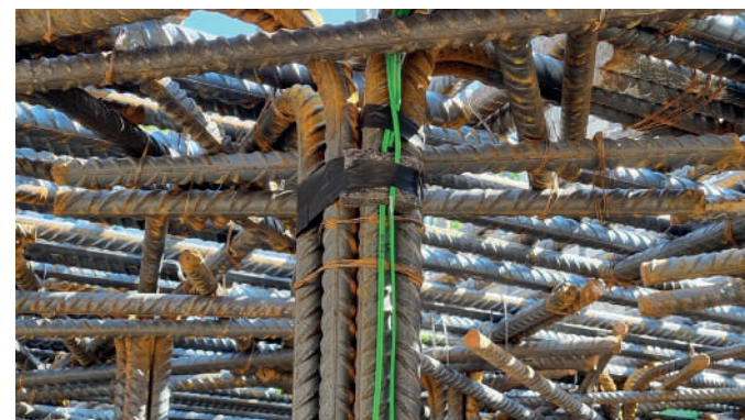
Sensore di temperatura posizionato all'interno della platea
