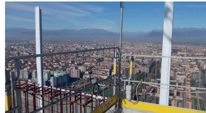
Installazione di tacogonioanemometro in copertura
