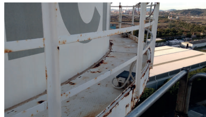
Rilievo del degrado dell'intradosso del serbatoio
