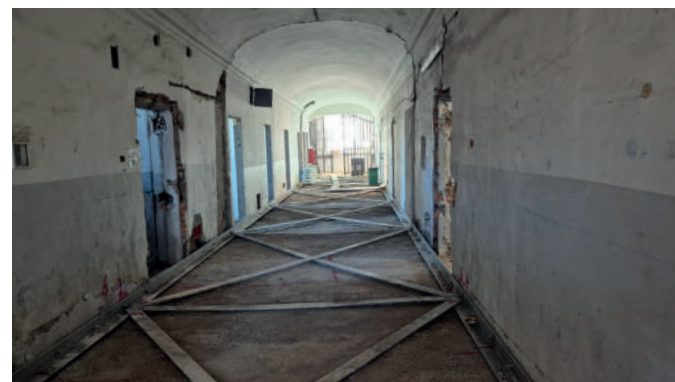
Cerchiature metalliche di piano
