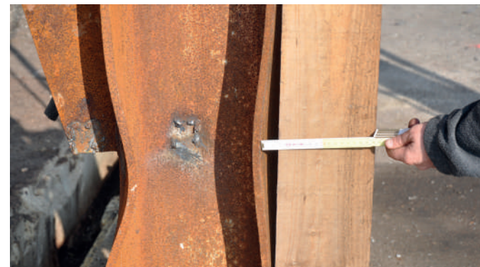
Rilievo dei dissesti
