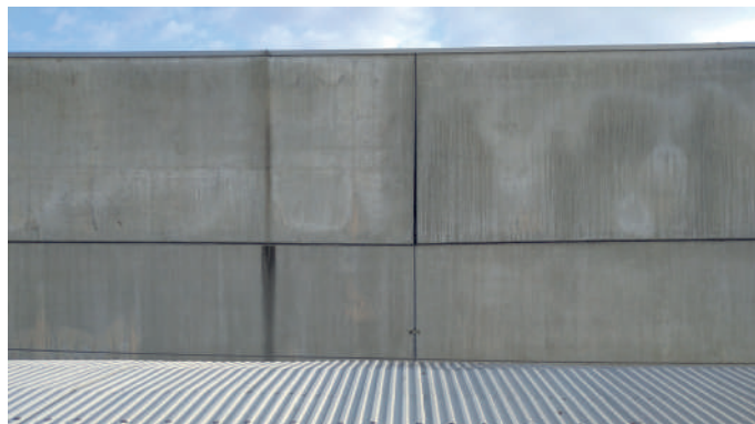
Dissesti in copertura riconducibili al cedimento
