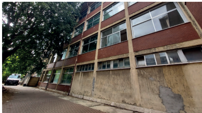
Vista dall'esterno del pilastro oggetto di cedimento
