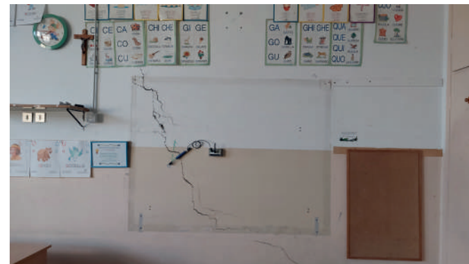
Fessurazioni su setto riconducibile al cedimento
